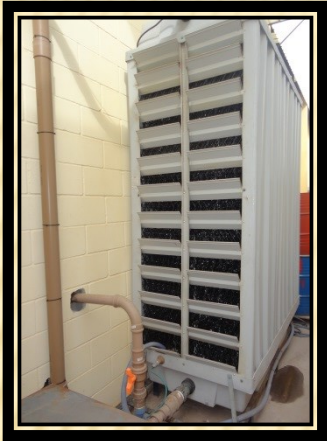
Torres de Refrigeração
